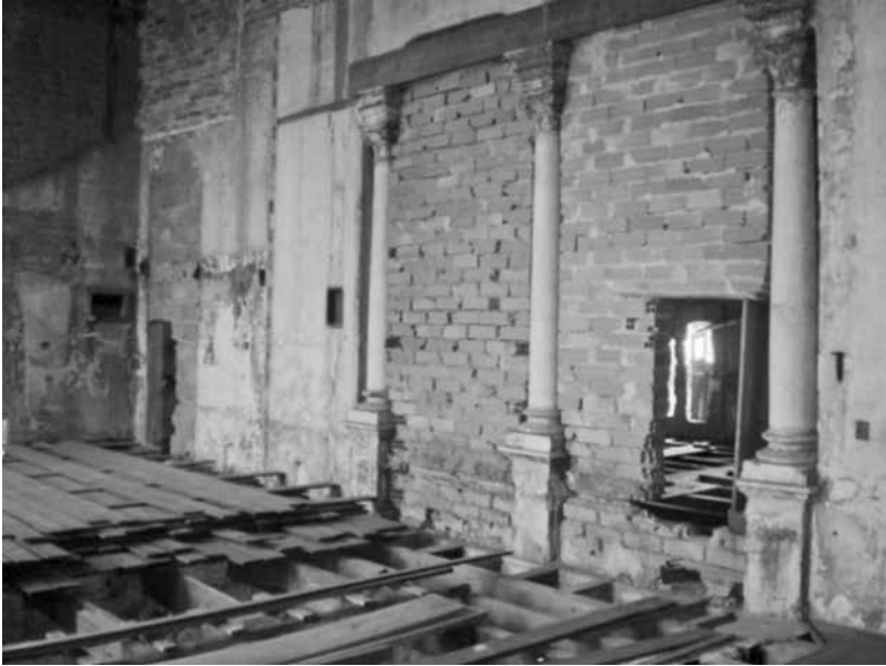
Figura 8 - 2º andar afetado pelo incêndio
